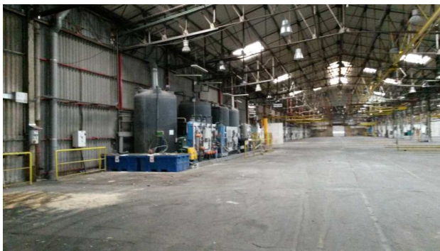
Hall 2: STEP – cuves de traitement au RDC
