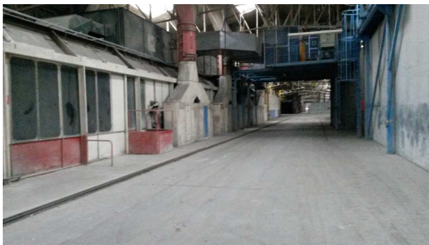
Hall 3 : Cabine Tunzini
